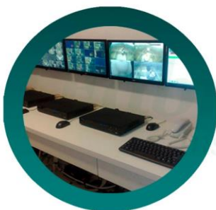
Central de Monitoramento
