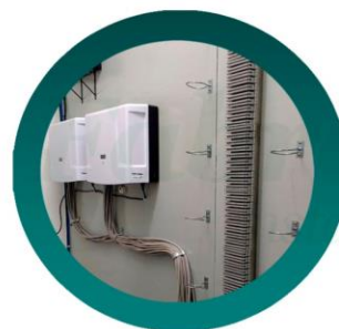
Sistema de Telefonia e Interfonia
