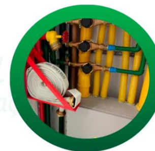
Proteção Contra Incêndio
