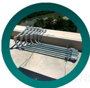
Tubulação e Infraestrutura
