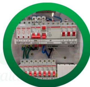
Quadro de Distribuição
